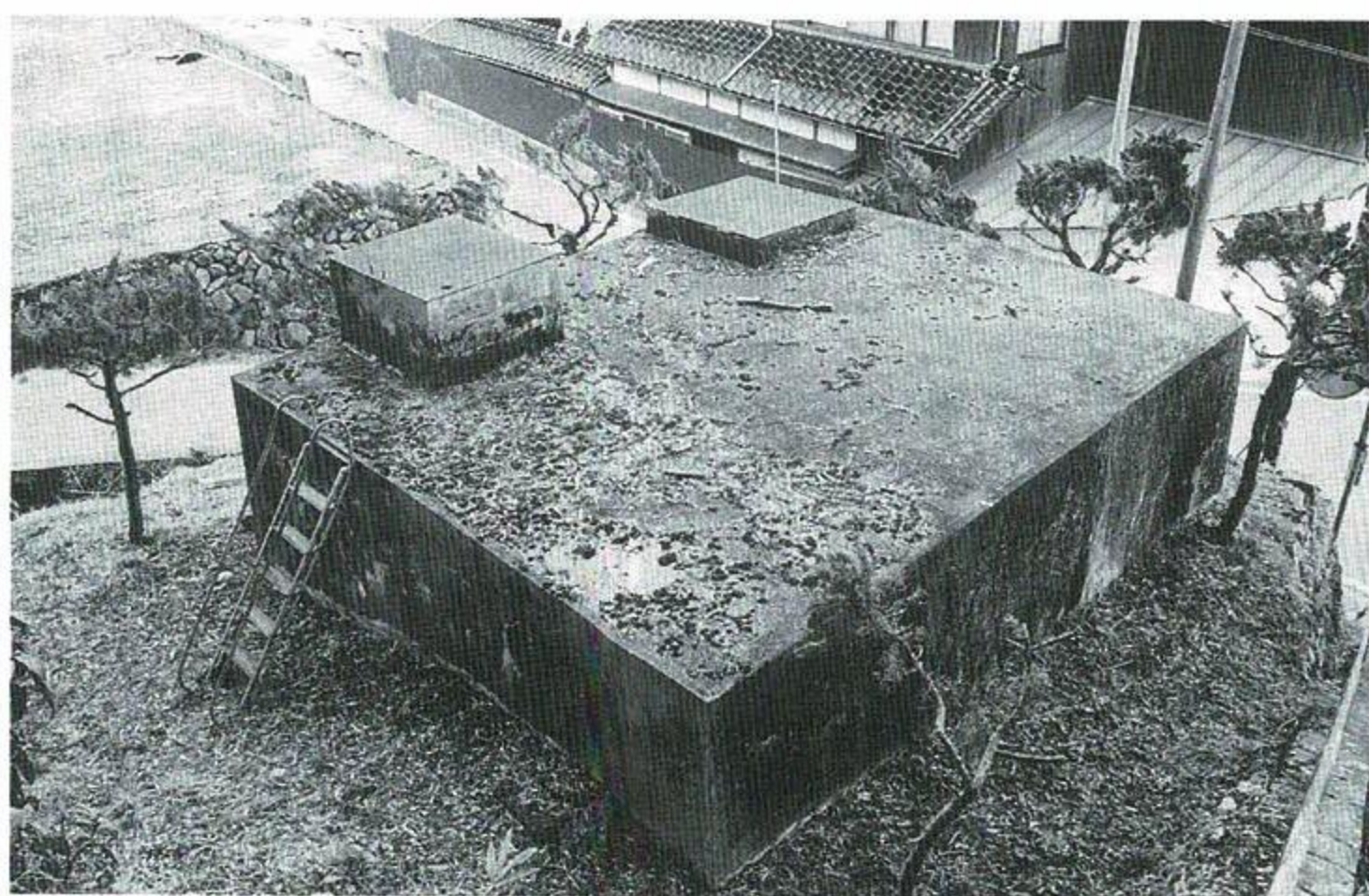
新明神社下にある貯水タンク
